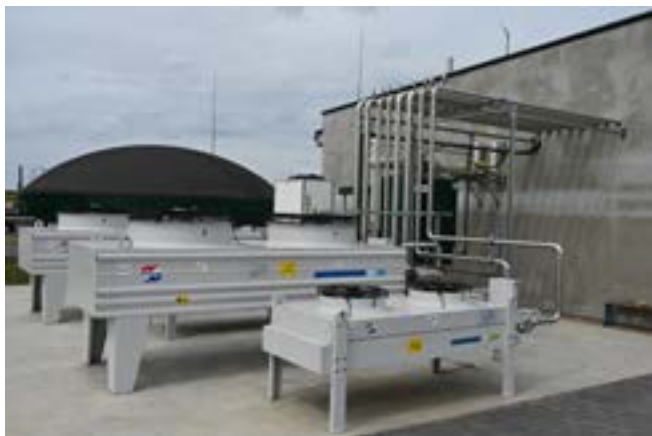
Systemy chłodzące biogaz rolniczy wraz z filtrami oczyszczającymi
