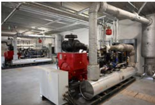
Jednostki kogeneracyjne napędzane biogazem, wytwarzające energię elektryczną
