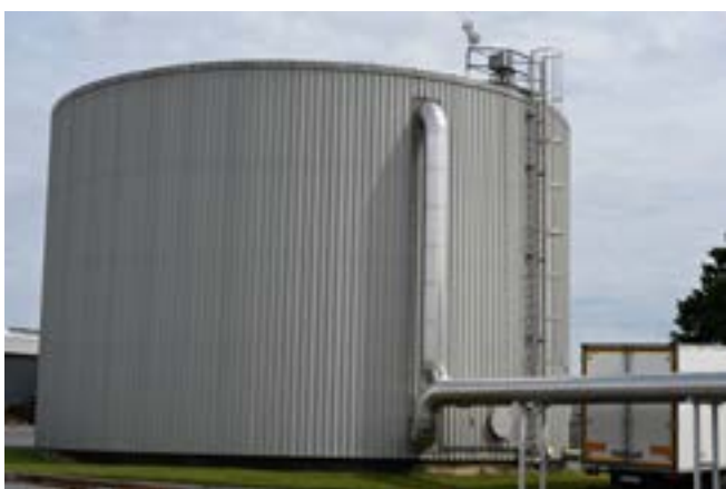
Zbiornik na gorącą wodę o poj. 2 000 000 litrów
